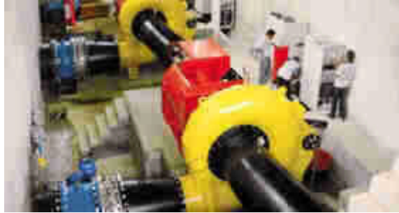
Οικίσκος 2 υδροστρόβιλων τύπου Francis κατασκευής WKV AG.
